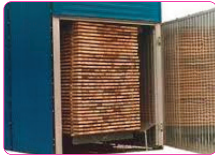
Şəkil 2. Mişar materiallarının qurutma kamerasında qurudulması
